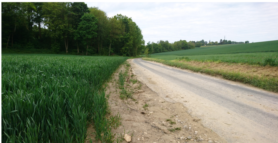
Figure 16 : Route de fond de vallon, récupérant les ruissellements et érodée
